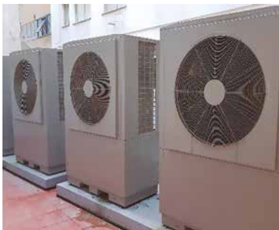
Gráfico 5-8. Caso de éxito cuatro. BdC en cubierta y bombas circuladoras
