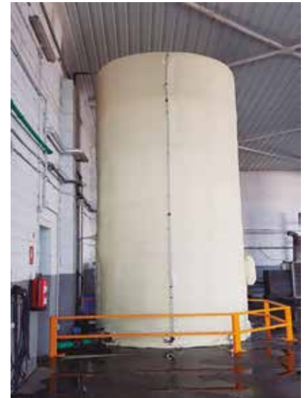
Gráfico 5-30. Caso de éxito once. Depósito de acumulación de agua caliente
